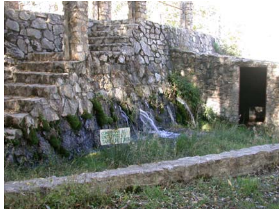
Salidas en muro del estanque (Crisanto Martín Montañés)
